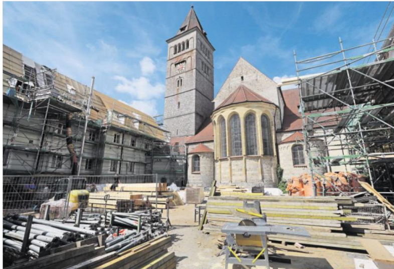
Der Hof des Kastler Klosters dient derzeit hauptsächlich als Lagerraum für diese riesige Baustelle. Der Umbau des zuletzt als ungarisches Gymnasium genutzten Gebäudekomplexes in eine Polizeihochschule für 120 Studenten kostet am Ende rund 60 Millionen Euro.
