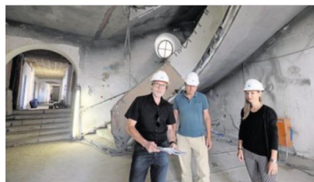
Auch das Treppenhaus aus den 50er Jahren ist bereits denkmalgeschützt. Im Bild von links: Der Bereichsleiter Hochbau beim Staatlichen Bauamt, Roman Beer, der Bereichsleiter Amberg-Sulzbach, Christian Kopf, und Baupraktikantin Eva-Maria Schiederer.
