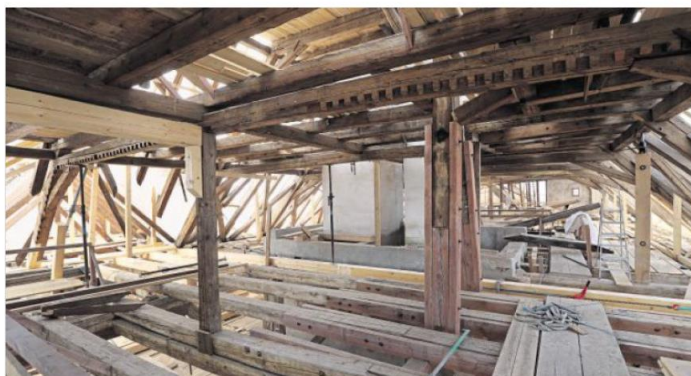
Der Dachstuhl im Nordtrakt war von Anfang an viel zu groß. Über die Jahrhunderte wuchsen die Schäden zu gewaltigen Störungen, die jetzt mit einem Millionenaufwand beseitigt werden müssen. Bilder: Wolfgang Steinbacher (3)
